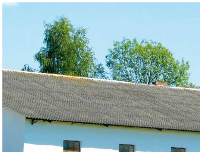
Fot. 6.2 Pokrycie dachowe z eternitu (płyty falistej), fot. archiwum WIOŚ Łódź
