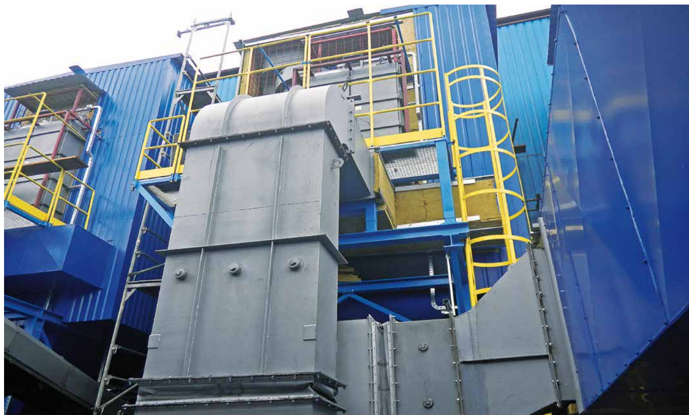
Fot. 7.2 Instalacja odpylania spalin w kotłowni budynków SM „Przodownik” w Tomaszowie Mazowieckim
