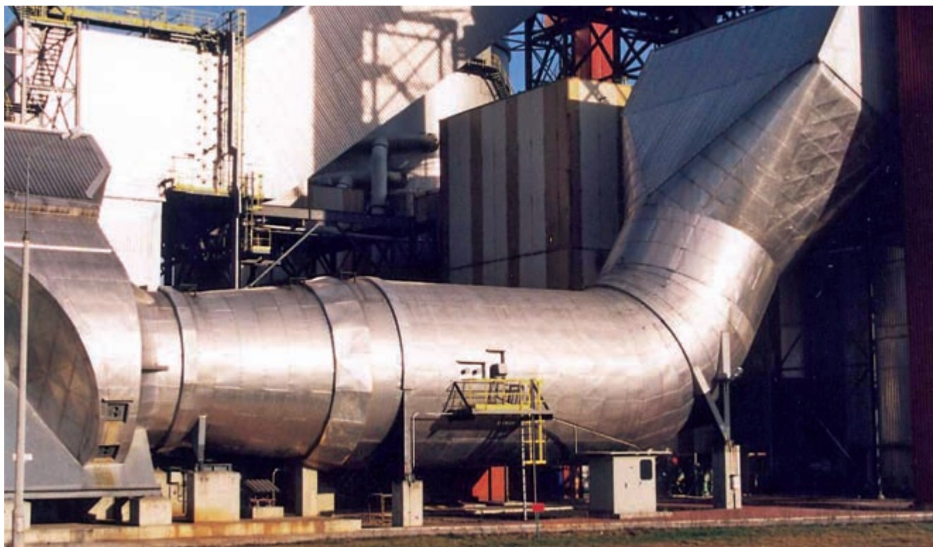
Fot. III.6 Wentylator wspomagający absorbera bloku 12, fot. archiwum elektrowni Bełchatów
